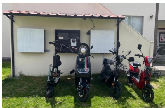
Fig. 4. Pruebas de funcionamiento del Sistema Fotovoltaico de Carga Directa
