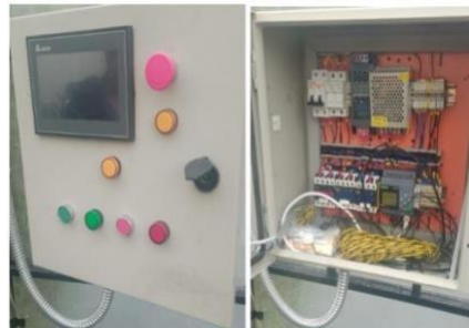
Figura 3. Sistema de control y potencia, Fuente: Realización propia
